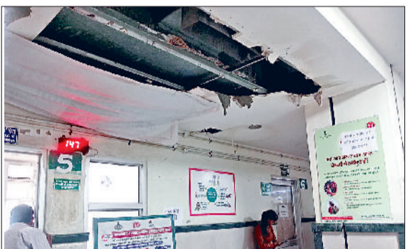
सोनीपत। नागरिक अस्पताल में 5 नंबर कमरे के बाहर छत की टूटी सीलिंग।
